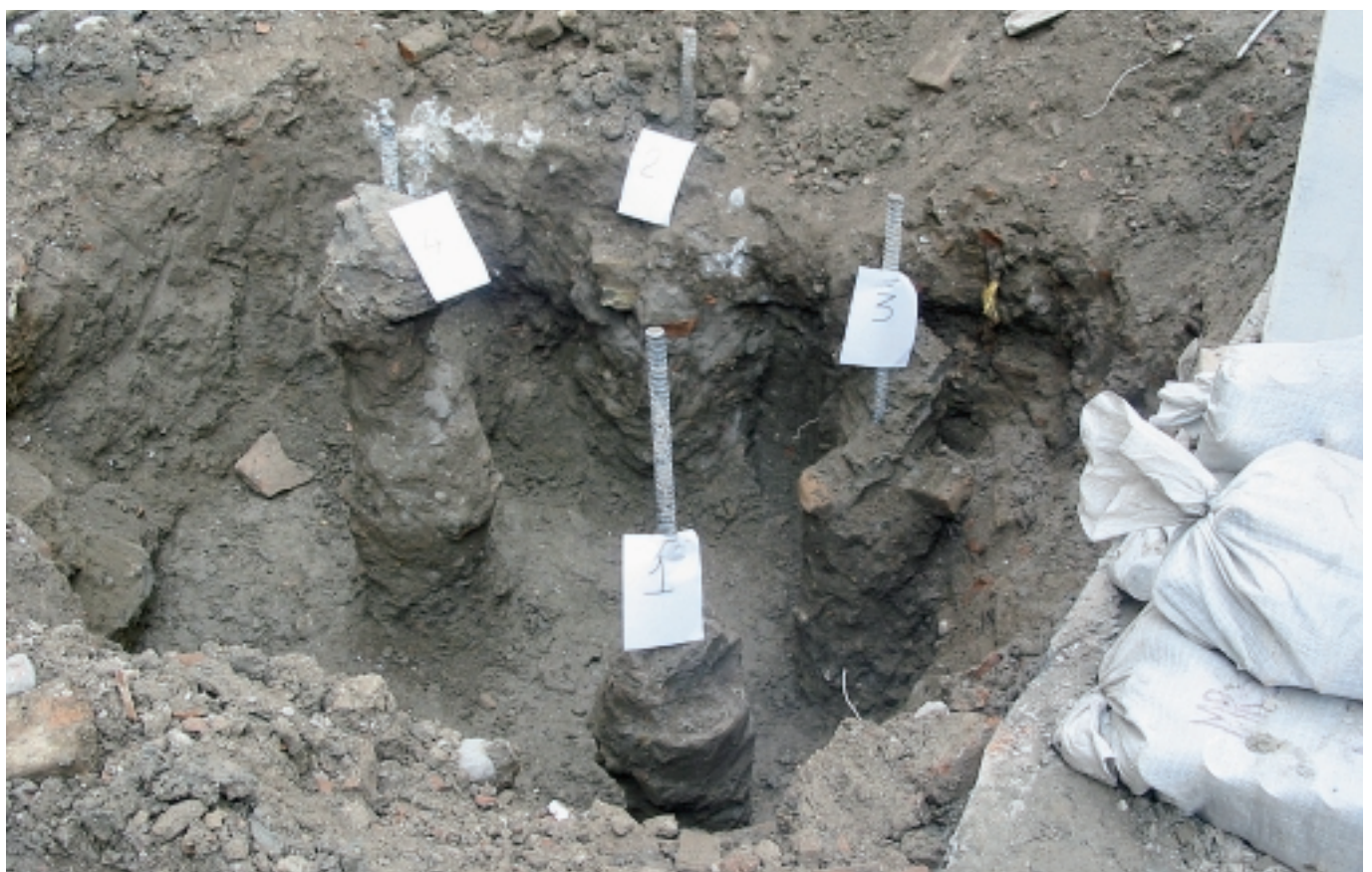
Fig. 24 - Colonne "MINIJET" ( \varnothing min. = 0,3 m) con barra d'armatura \varnothing 32 mm "MINIJET" columns ( \varnothing min. = 0.3 m) with \varnothing 32 mm hollow steel rod.
